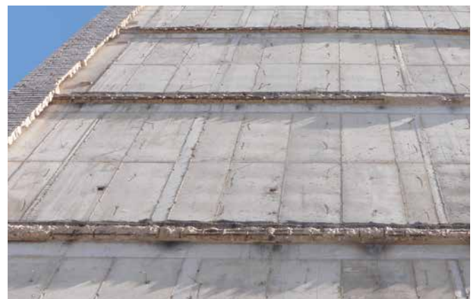
Vormauerschale komplett abgelöst; Drahtanker korrodiert | Facing completely detached; wire anchor corroded
